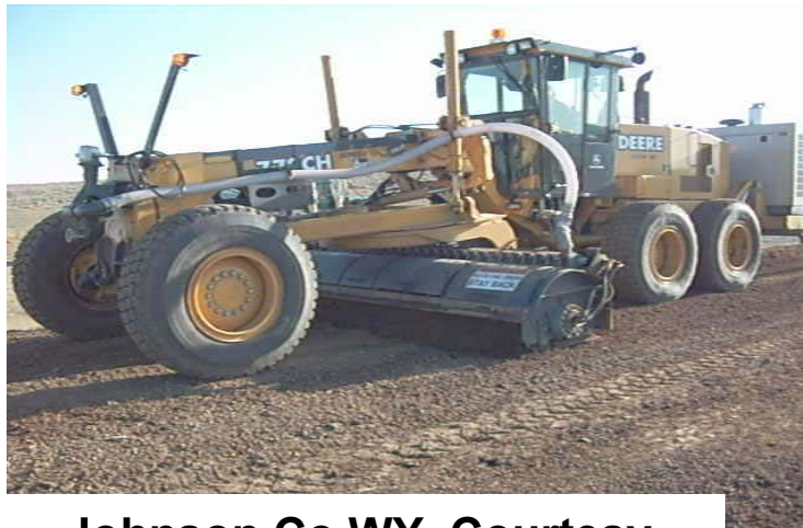
Johnson Co WY, Courtesy, Oxford Inc, Moyie Springs ID
